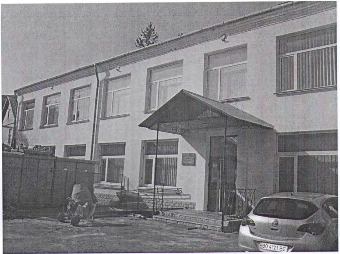
Рисунок Д.2.1 – Загальний вигляд пандусу на фасаді будівлі Лабораторного корпусу №1, що знаходиться за адресою вул. Академічна, 20 в м. Березжани Тернопільської області
